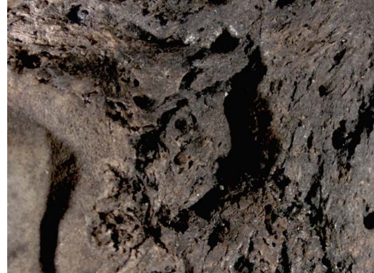
Fotografía 26 Detalle de las fisuras (Fotomacroscopio 6,3x)
