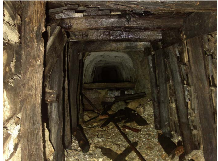
Fotografía 7. Mina los Italianos. Entrada con el derrumbe. Fotografía de Angel García.
